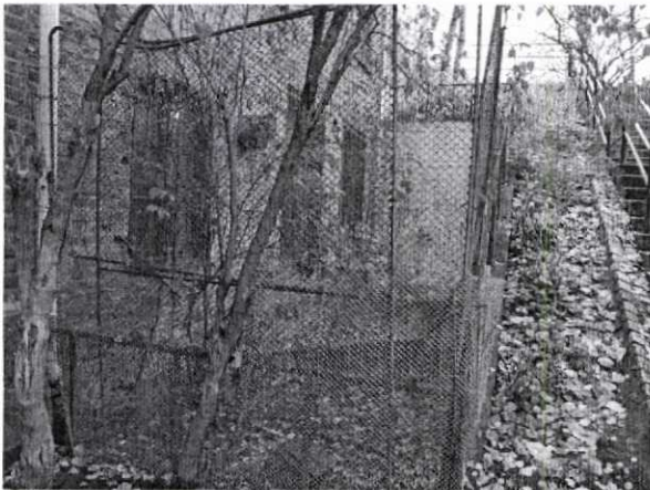
Plassering av aggregat i smug mellom fasade og trapp
