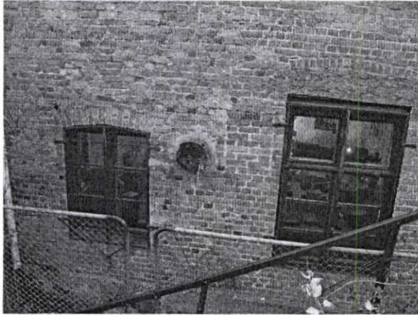
Eksisterende ventilasjonssystem som ikke er i bruk
