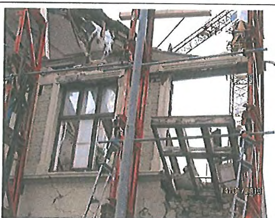
Bilde 3 – nærbilde av skadene i 3. og 4. et. på NV del.
