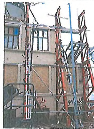
Bilde 2 – fasade mot Marstrandgate, skader NV del av fasaden.
