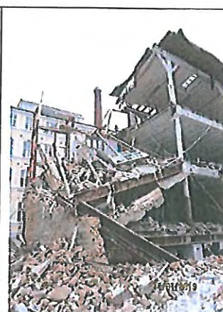
Bilde 4 – rivemasser som ligger inntil fasaden
