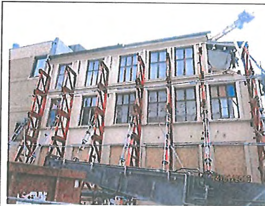
Bilde 1 – fasade mot Marstrandgate, skader på NV del av fasaden.
