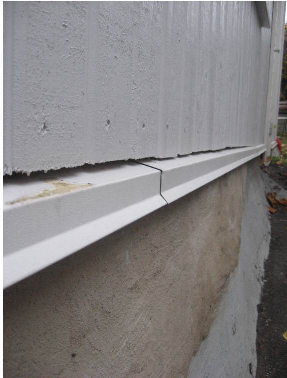
Overgang panel mot grunnmur i dag foto 3
