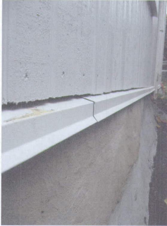
Overgang panel mot grunnmur i dag foto 3
