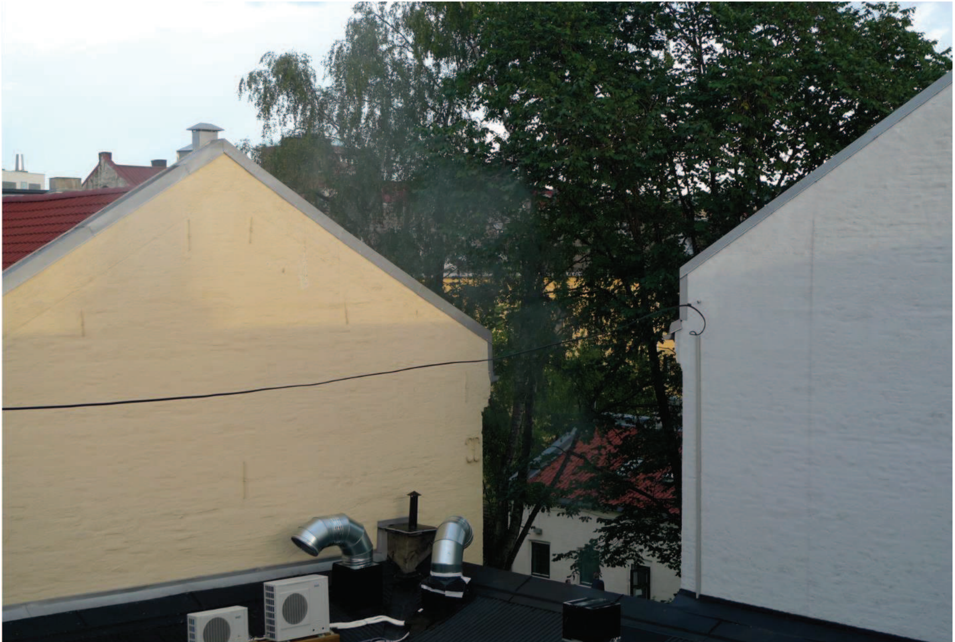
Bildet av avtrekksvifte Korsgt 25 - tatt 12/8-2013 kl 20:10
