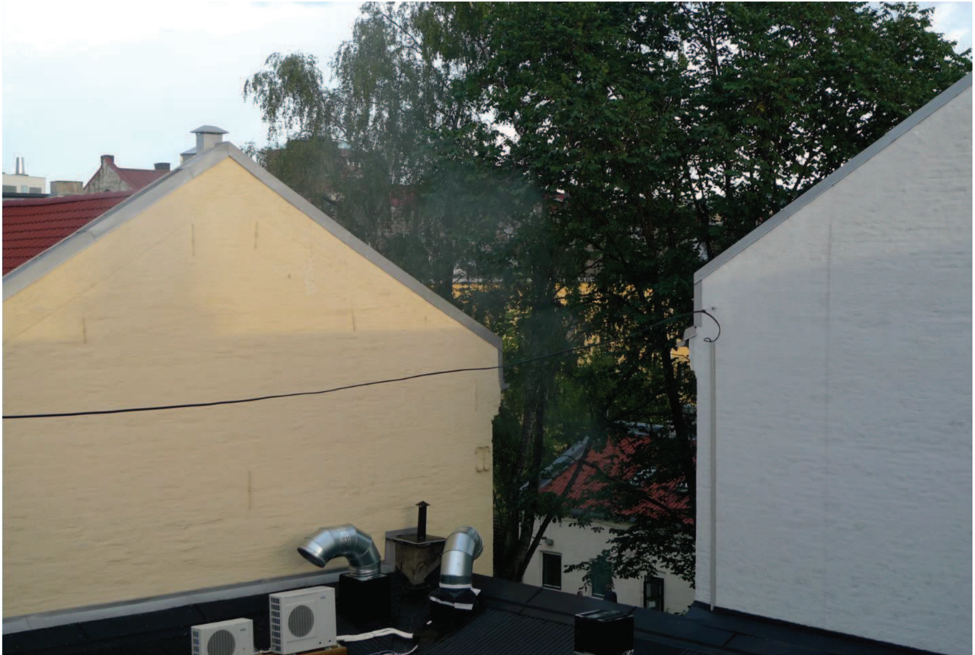
Bildet av avtrekksvifte Korsgt 25 - tatt 12/8-2013 kl 20:10
