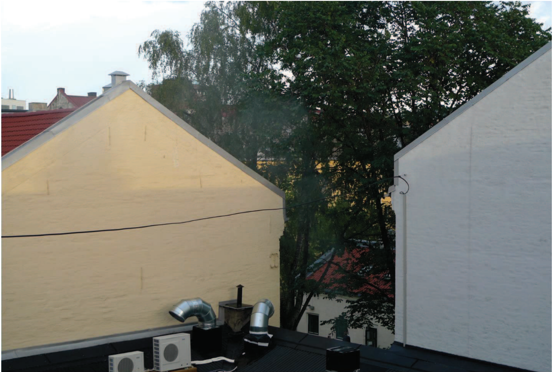
Bildet av avtrekksvifte Korsgt 25 - tatt 12/8-2013 kl 20:10
