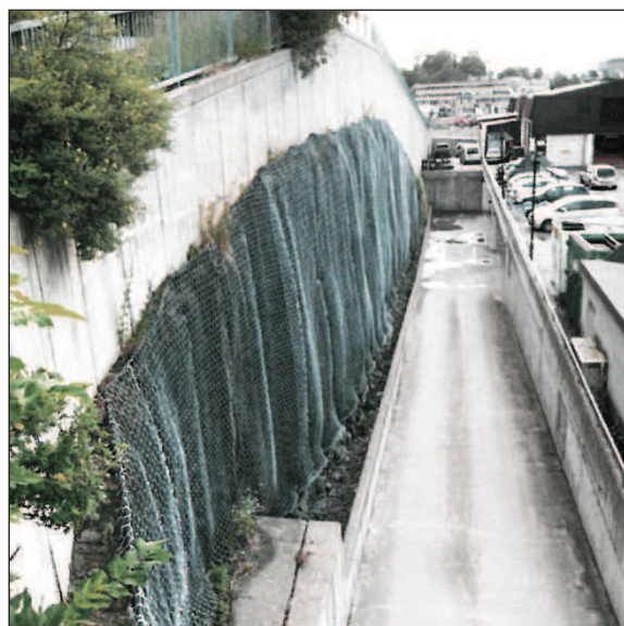
Fig. 21: Bergskjæring langs eiendomsgrensen mellom Lørenfarete 1B og Lørenveien 68. (Foto: Sweco Norge AS)
